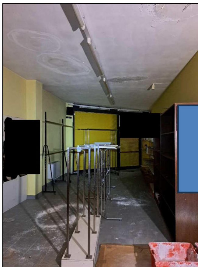
FOTO 19: lato ovest del negozio-ingrosso con evidenze, a soffitto, del plurimo degrado superficiale da penetrazione umida.
