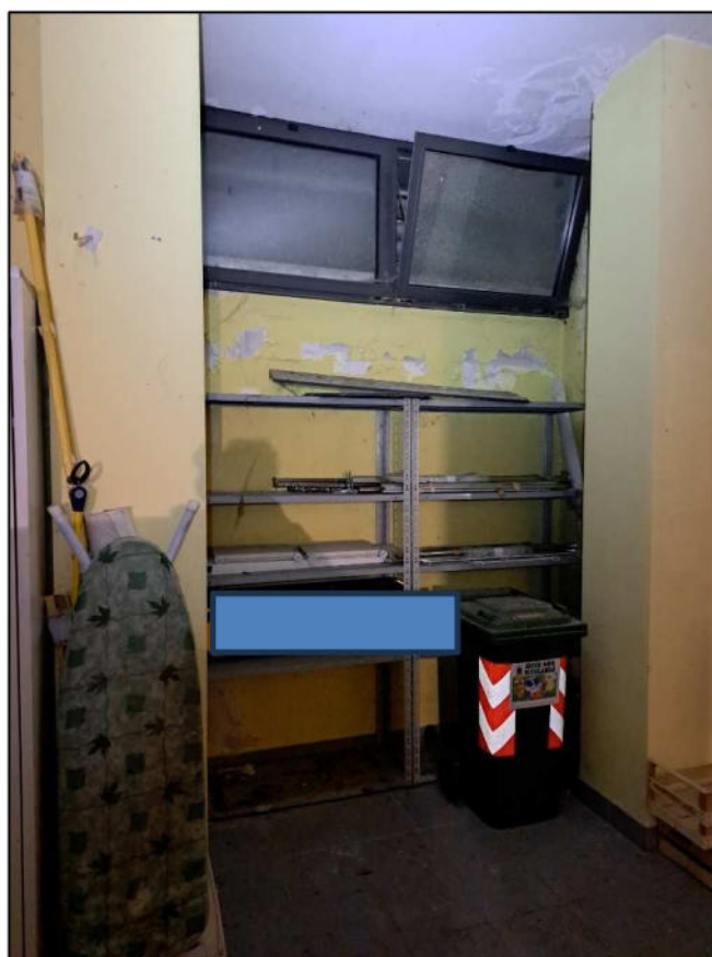
FOTO 25: deposito 1, apertura finestrata lato est, su bocca di lupo. Evidenza degrado superficiale da stillicidio.
