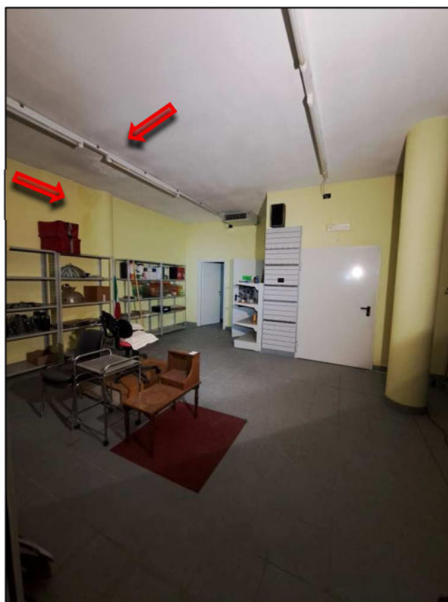
FOTO 23: frangente nord dell'ala est del negozio-ingrosso; evidenza degrado superficiale da stillicidio.
