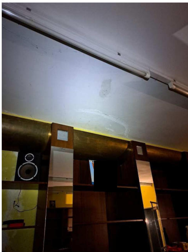
FOTO 17: degrado superficiale da penetrazione umida nel frangente centrale nord, lato est, del negozio al dettaglio.
