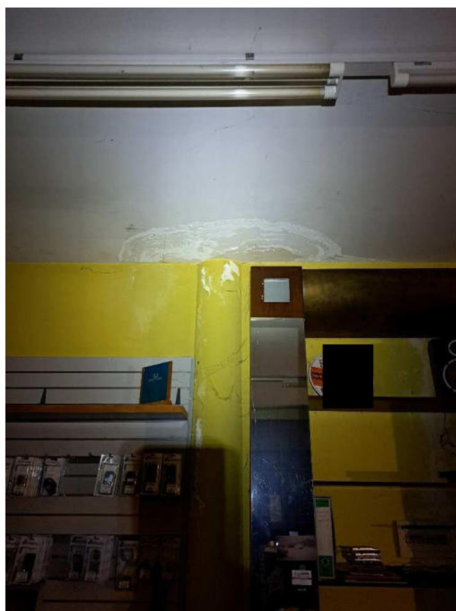
FOTO 16: degrado superficiale da penetrazione umida nel frangente centrale nord del negozio al dettaglio.
