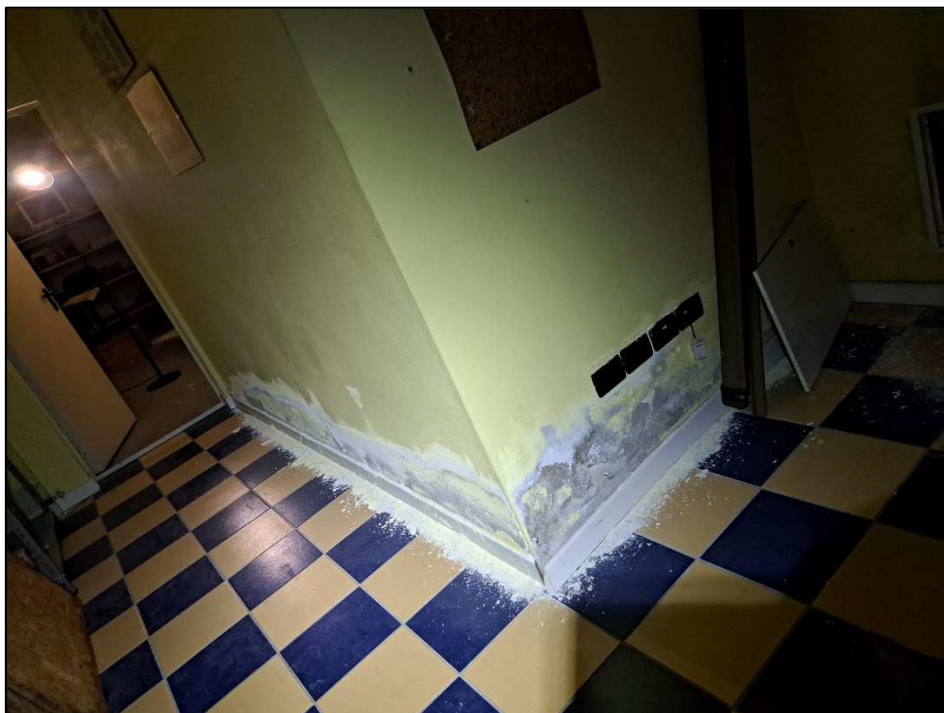
FOTO 32: deposito 1, frangente inferiore centrale nord ed ovest; evidenza degrado superficiale da stillicidio.
