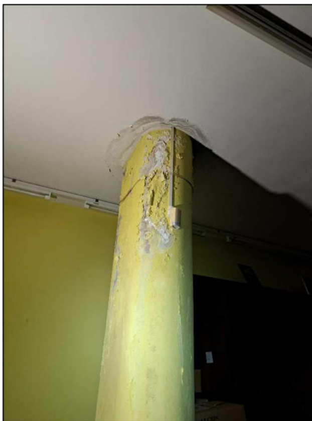
FOTO 18: degrado superficiale da penetrazione umida nel frangente sud, lato est, del negozio al dettaglio, in corrispondenza del pilastro ivi ubicato.
